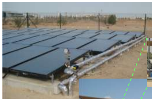
集熱器 設置状況
