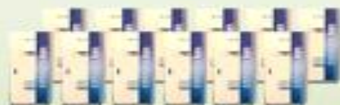
系統安定化蓄電システム (二次電池)
