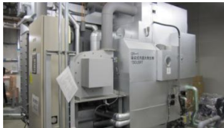
吸収式冷凍機: 411kW
