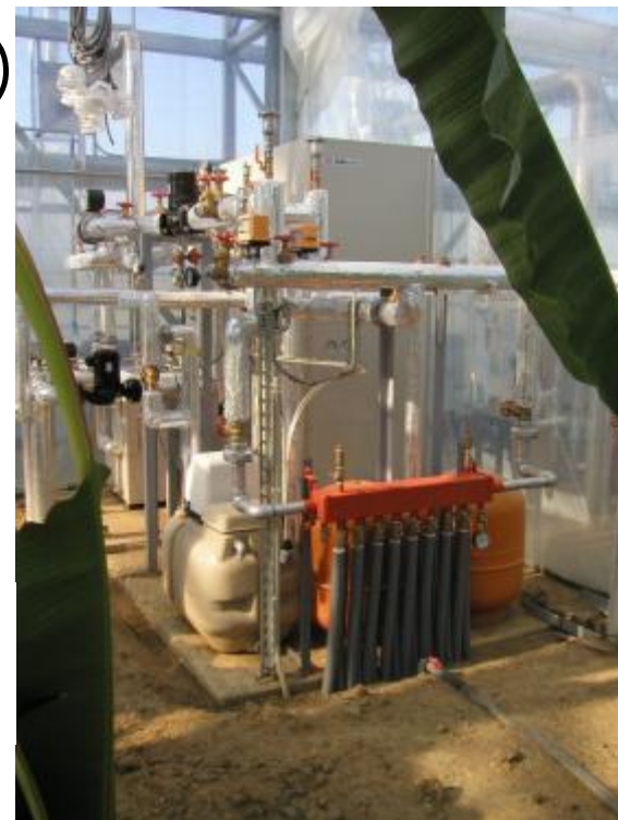
地下水熱源 ヒートポンプ
