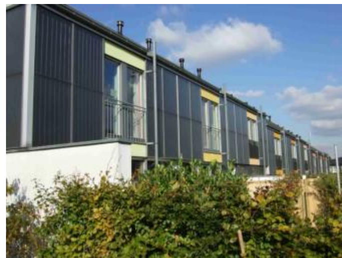
壁面設置の集熱器
