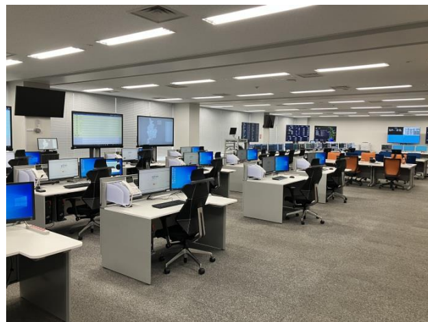
＜総合指令室内の様子＞
