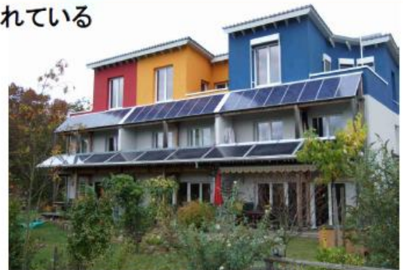
庇に設置した集熱器
